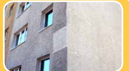
Fassadenreinigung: Viele WOBAU-Mieter freuen sich über die frisch gereinigten Fassaden im Wohnungsbestand, wie in der Berliner Straße, der Alten Brauerei, der Schönower Chaussee, dem Saturn- und Uranusring, der Gorkistraße dem Platz Champigny-sur-Marne
